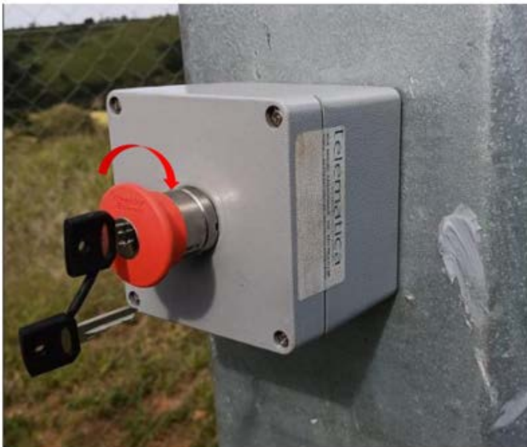
Figura 8.3-4 – Botoeira de emergência (acionamento manual)
