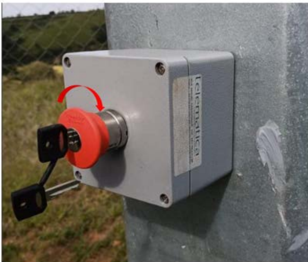
Figura 8.3-4 – Botoeira de emergência (acionamento manual)
