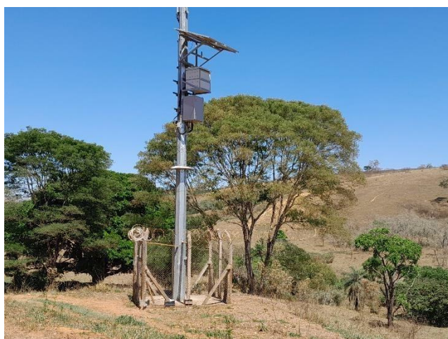
Visita de campo - Instalação da Sirene 03 . Barragem Sabão Serra do Salitre (MG), 12/09/2023
