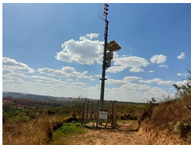
Visita de campo - Instalação da Sirene 04 . Barragem Sabão I, EuroChem Salitre LTDA. I, EuroChem Salitre LTDA. Serra do Salitre (MG), 12/09/2023
