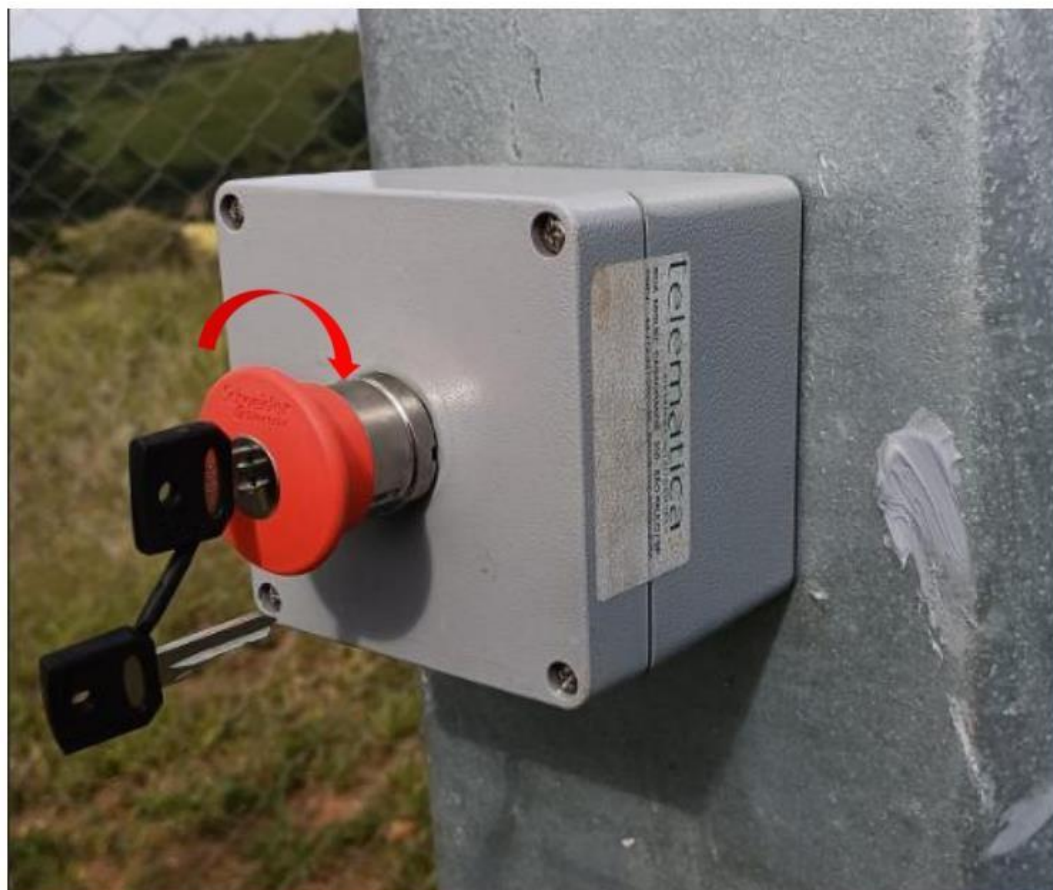
Figura 10.4 - Botoeira de emergência (acionamento manual).
