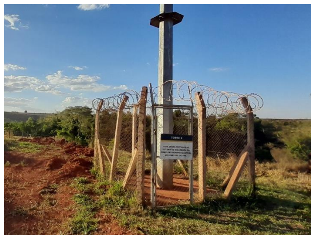
Visita de campo - Instalação da Sirene 02 . Barragem Sabão I, EuroChem Salitre LTDA. I, EuroChem Salitre LTDA. Serra do Salitre (MG), 12/09/2023
