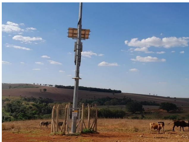
Visita de campo - Instalação da Sirene 01 . Barragem Sabão Serra do Salitre (MG), 12/09/2023
