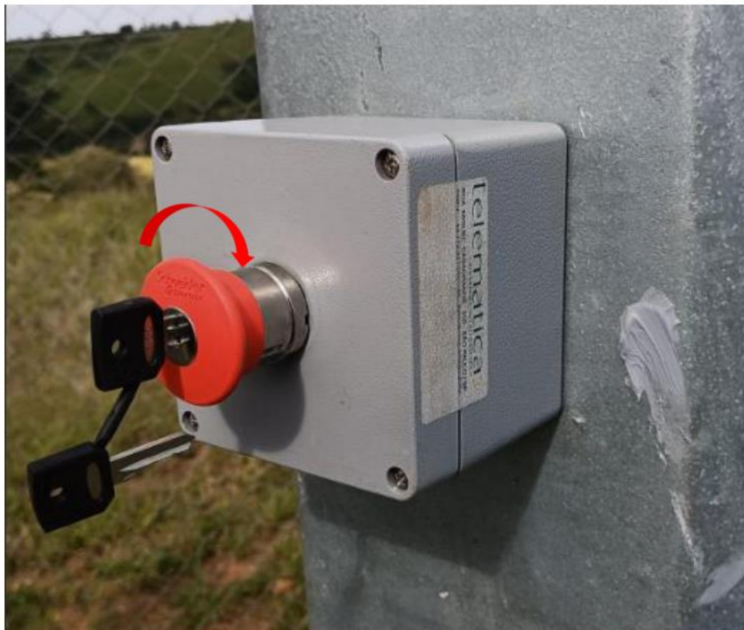
Figura 11.4 - Botoeira de emergência (acionamento manual).
