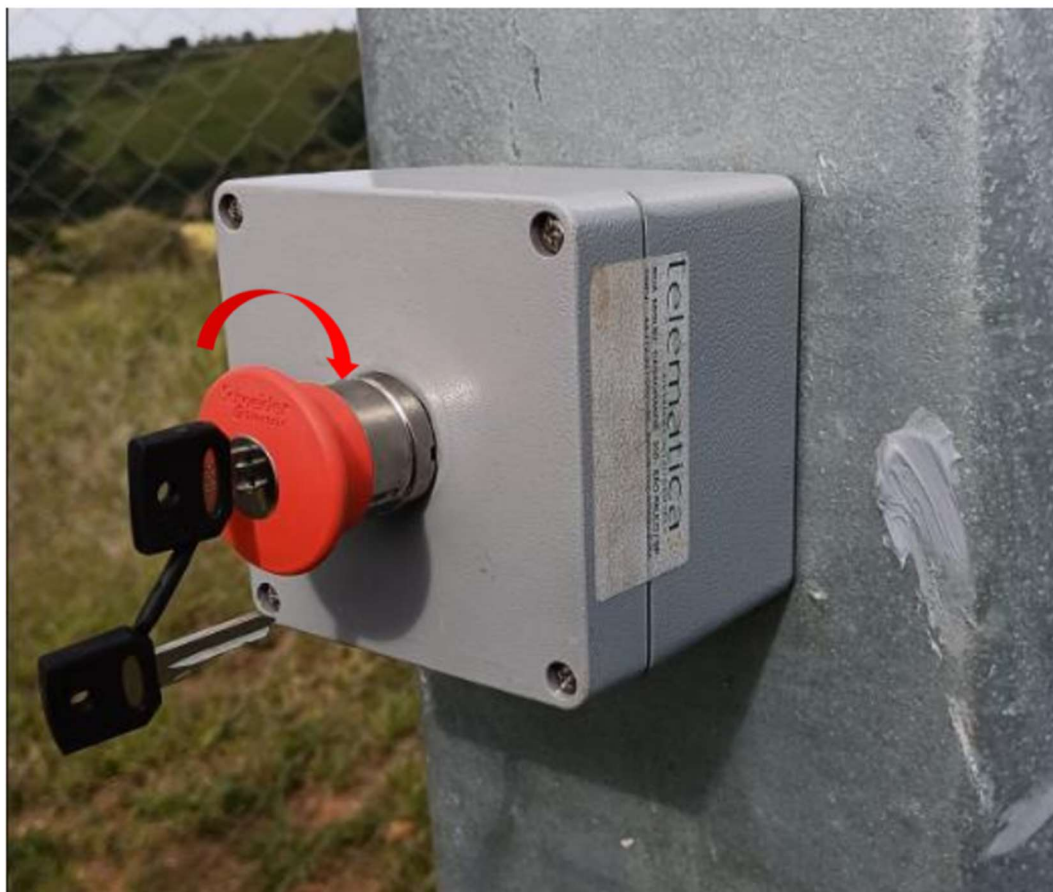
Figura 11.4 - Botoeira de emergência (acionamento manual).
