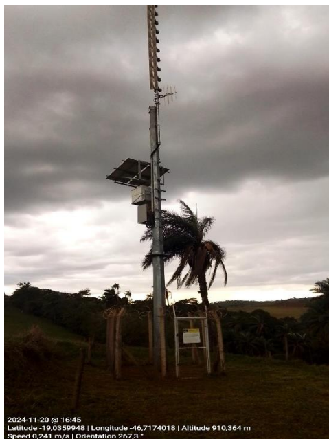
Visita de campo – Instalação da Sirene 290-EC-007 . Barragem Sabão I, EuroChem Salitre. Serra do Salitre (MG), 20/11/2024
